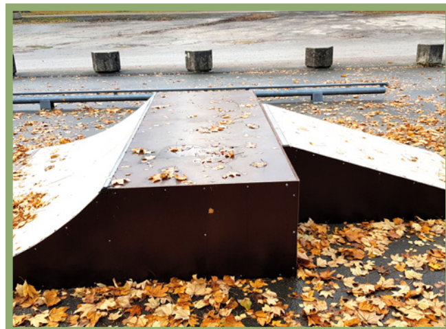
Die Skateranlage hatte schadhafte Stellen und wurde durch den Baubetriebsdienst abmontiert, repariert und wie gewohnt wiederaufgebaut.
